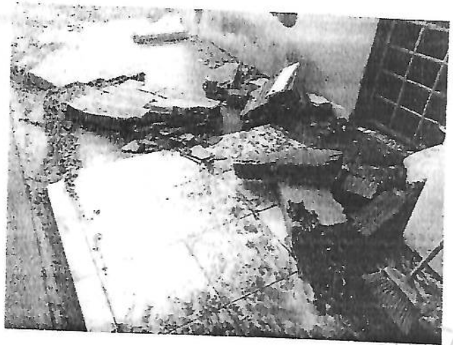
ENTULHOS DO MURO PASSANDO PELA GARAGEM:
